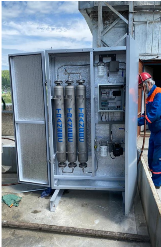
ТРДЦН-63000/110-У1Б, 3Т, Приуфимская ТЭЦ (ПП Павловская ГЭС) ООО «БГК»
