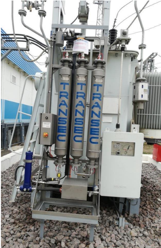
ТДНС-10000/35, Т-2, ПС-35 кВ «Латухино-2» Саратовский филиал ООО «Газпромэнерго»
