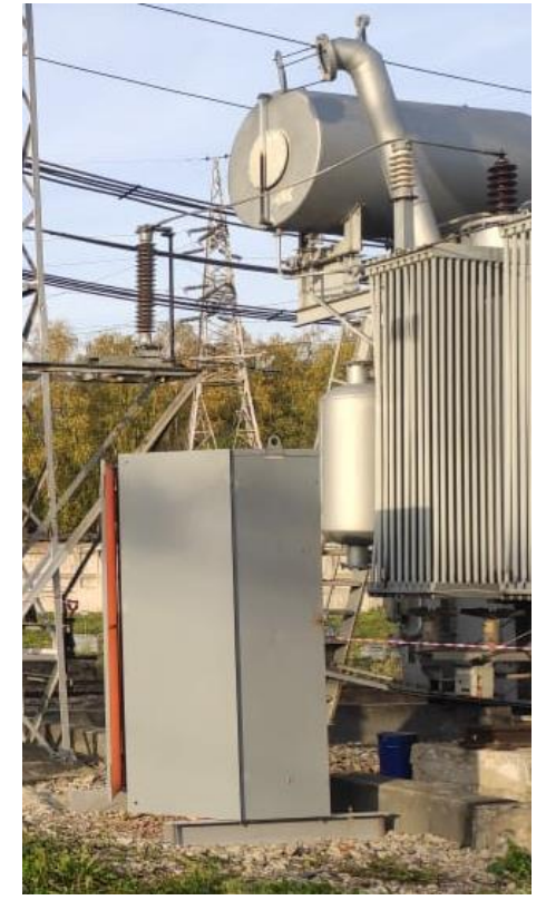
ТДТНГ 20000/110, Т-3, ПС Подлипки СЭС Россети Московский регион
